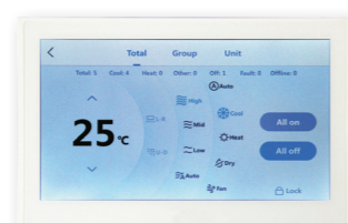
Центральный пульт управления QA-RPGC
